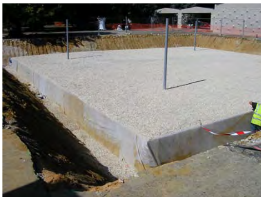
Photo 3.7 : Exemple de ventilation par évent
