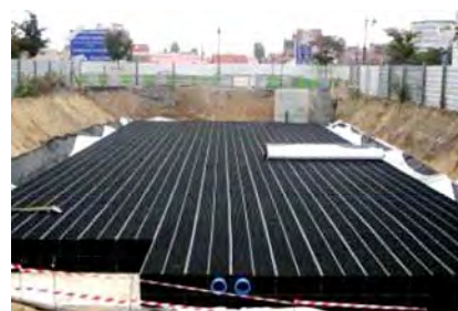
Photo 3.3 : Exemple de SAUL à diffuseur interne
